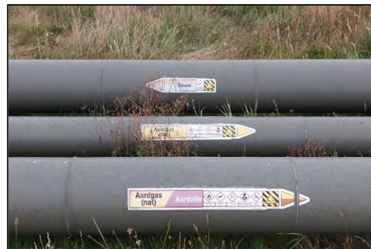
Figuur 4.10 Aanwezige bovengrondse leidingen.
