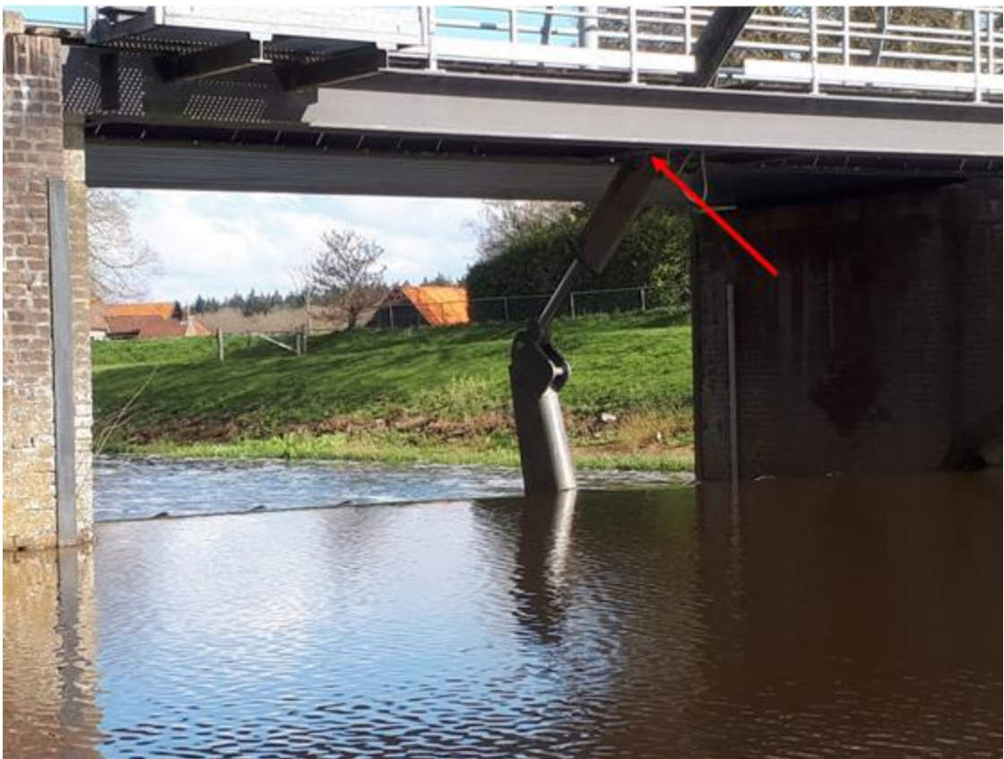
Nestplaats grote gele kwikstaart (en later boerenzwaluw) boven de aanhechting van de hydrauliek cilinder van de westelijke stuwklep. Foto Ecogroen
