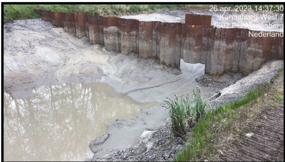
Foto 2: Geopende schuif tussen bassin 1A en 1B gezien vanuit bassin 1A
